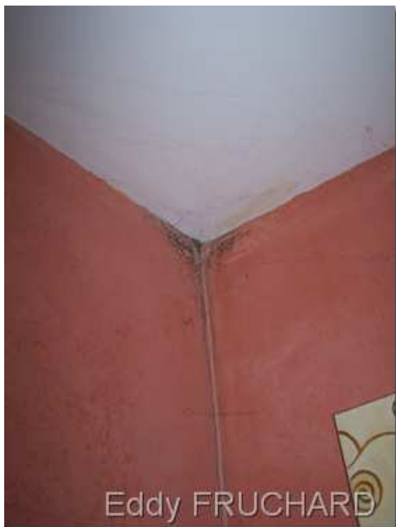
Problème dans les angles de murs
