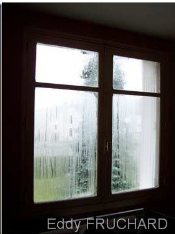
Condensation sur menuiserie car simple vitrage
