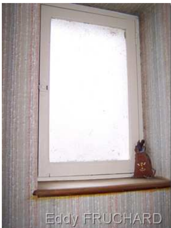
Moisissure sur la tapisserie à droite car mauvaise isolation entre la menuiserie et le mur existant.
